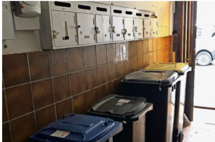
Null Brandschutz: Müll, Elektroanlage und offene Haustür – Treppenhäuser wie hier in der Goethestraße sind der Albtraum der Feuerwehr. Foto König
